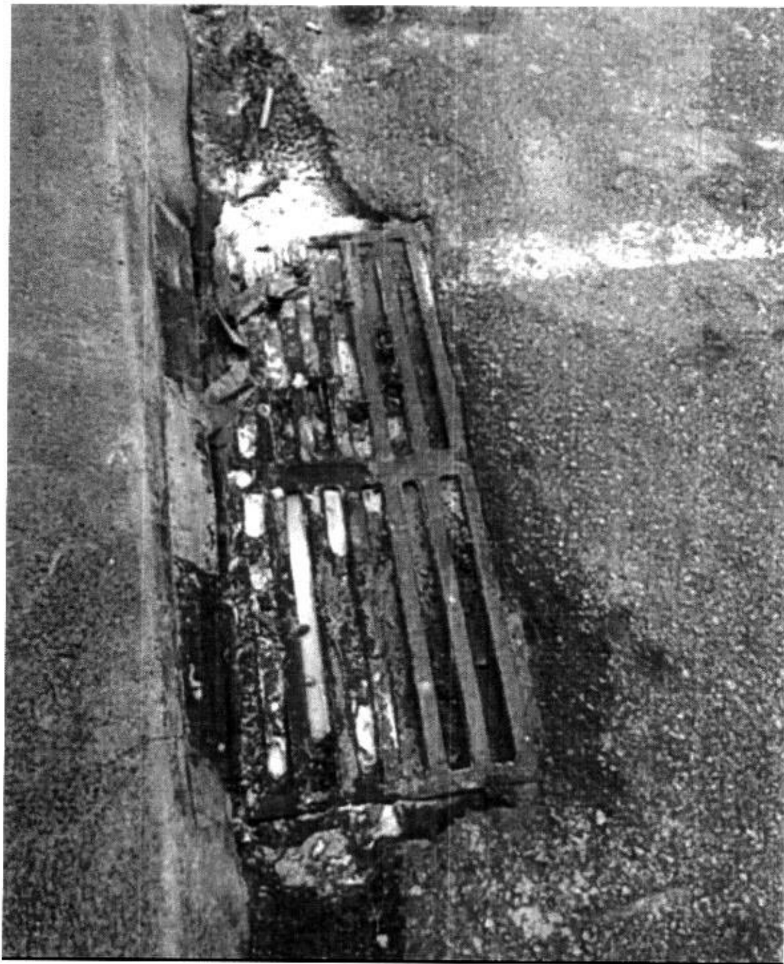
Bueiro obstruído na rua Hildebrando Santana, Bairro Rosário
