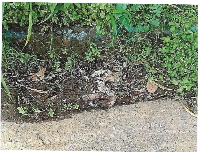
26 – Lourdes – Rua Barão de Cocais, 303 (curva da fazendinha) – 2 bueiros próximos do mesmo lado da rua
