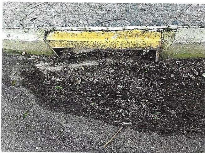
14 – Aclimação – Rua Santa Lúcia, 510 [2 bueiros na calçada da AMEPI]
