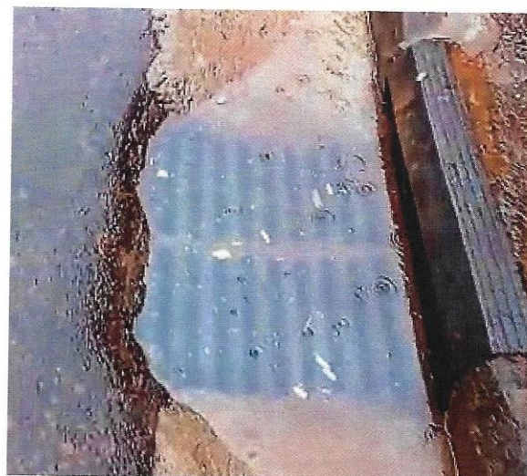
5 – Rosário – Rua Manoel Bandeira, 174 (está entupido na rede, bueiro cheio d'água)
