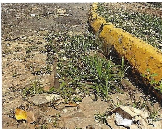
6 – Santa Bárbara - Rua Padre José de Anchieta, 862 (4 bueiros próximos, um de frente para o outro)
