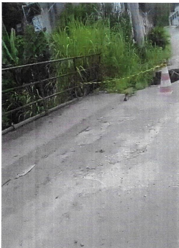
006-Erosão na ponte rua Gatasul
