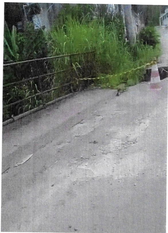
006-Erosão na ponte rua Gatasul
